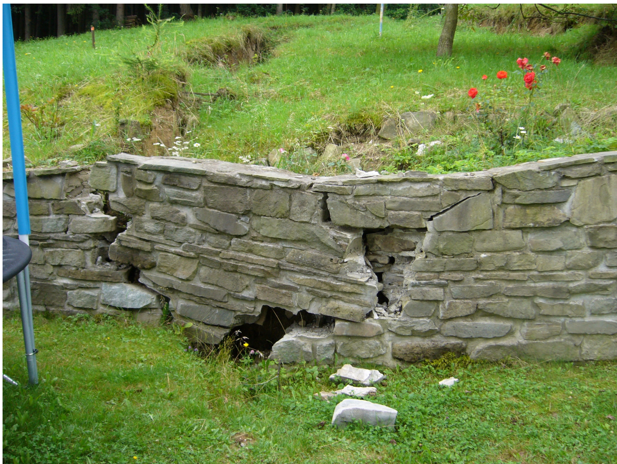
Obr. 13 K aktivizaci sesuvu v Kunčicích pod Ondřejníkem v trati Žáryská/Pekliska došlo v roce 1997 po katastrofických srážkách. Patrná je odlučná plocha sesuvu nad obytným domem a poškozená opěrná zeď. Stav k roku 2011.
